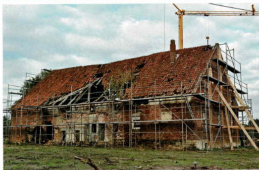
Bild 1: Den Verfall des Hauses an der Weidenstraße in Steinhagen-Ströben dokumentieren diese Fotos
