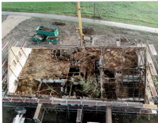
Bild 2: Nach Abbau des maroden Dachstuhls offenbart sich der darunter liegende marode Zustand
