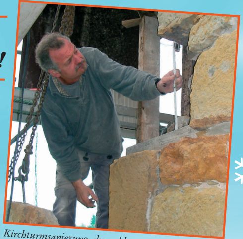
Kirchturmsanierung abgeschlossen – Restaurator Hubert Gruber beim Ausmessen der Sandsteine am Isselhorster Kirchturm“
