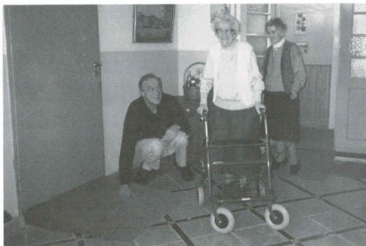
Kleine Hilfe – große Wirkung: über die eingebaute Rampe ist die Schwelle jetzt mit dem Rollator bequem zu überwinden.
