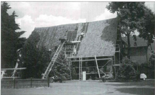
Die Holtkämperei – eines der ältesten Häuser in Issehorst
