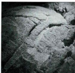
Neu vermörtelte Rißbereiche
