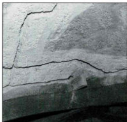
Gewölbeschäden von der Unterseite (Kircheninnenraum) aus
